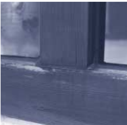
Mangel: Abplatzen der Beschichtung.
