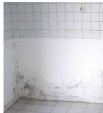
Schimmel hinter Möbeln an einer Außenwand: Keine Luftzirkulation, es entsteht eine feuchte Wand
