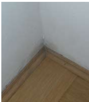
Schimmel im Keller: Ursache aufsteigende Feuchtigkeit, hier liegt ein baulicher Mangel vor
