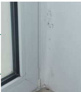
Schimmel in Fensternischen: Falsch eingebaute Fenster oder eine Wärmebrücke (Kondensat) führen zur Schimmelbildung
